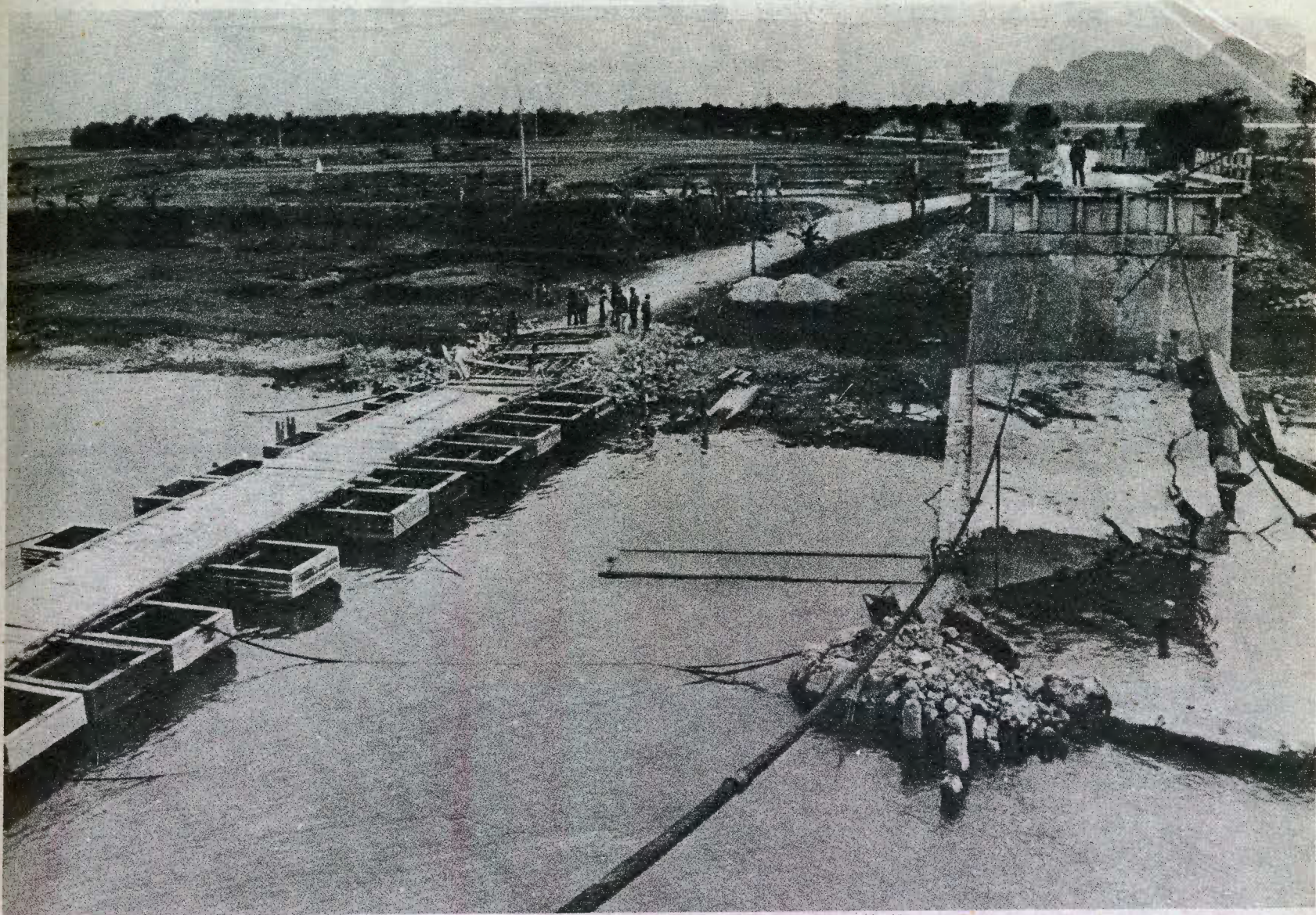
Junto al destruido, el nuevo puente desmontable descansa sobre enormes haces de bambú gigante
